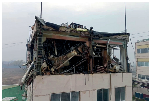
РИС. 4 ВИД ЦЕХА ПО ПРОИЗВОДСТВУ ТЕРИЗИДОНА ПОСЛЕ ВЗРЫВА И ПОСЛЕДУЮЩЕГО ПОЖАРА
